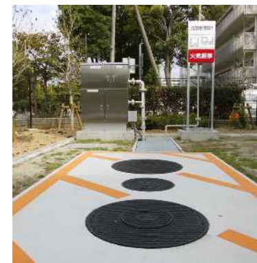
地下オイルタンク
