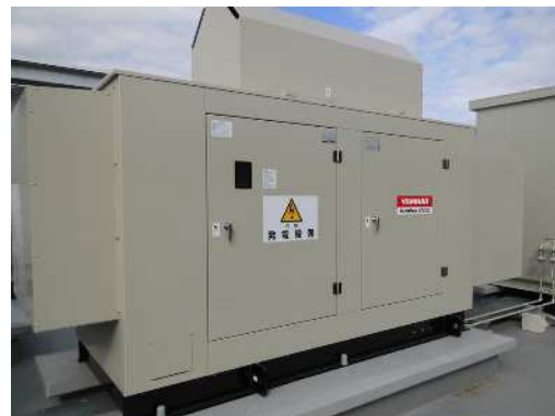
非常用発電機
