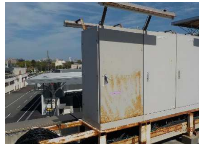
9号館屋上イベント盤
