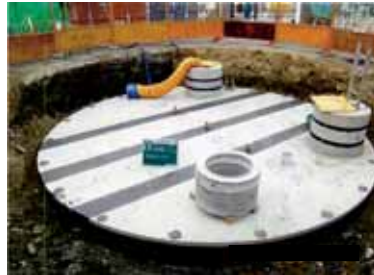
耐震性防火水槽 (潮江緑遊公園)
