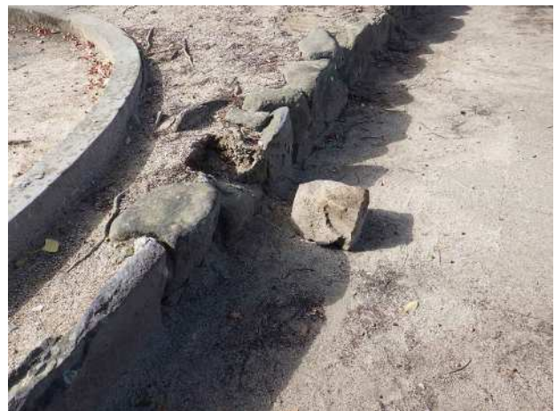
落下した石積み
