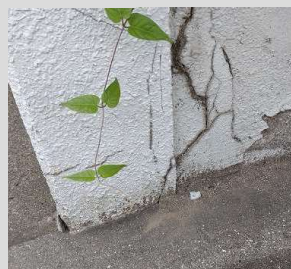
コンクリートの割れ目
