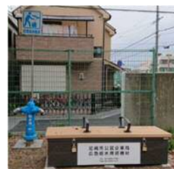
応急給水栓とベンチ式倉庫 (南武庫之荘中学校)
