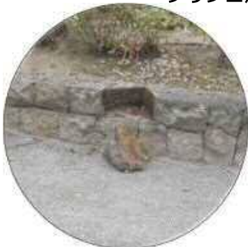
石積みがくずれている
