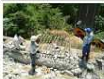
被災状況調査(現地調査)
