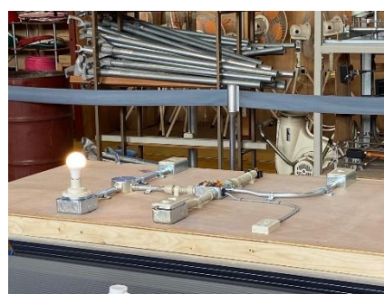
電気工事競技完成品
