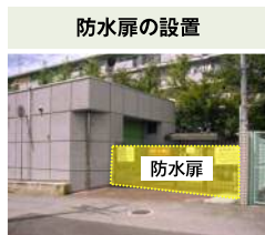
防水扉を設置することで、施設を浸水から守ります。
