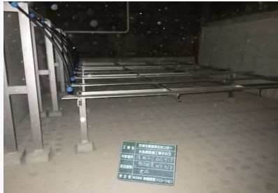
反応タンク:散機装置
