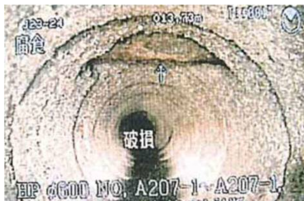
【破損した管きよ】
