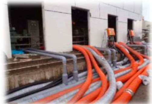
被災したポンプ場の送水状況
