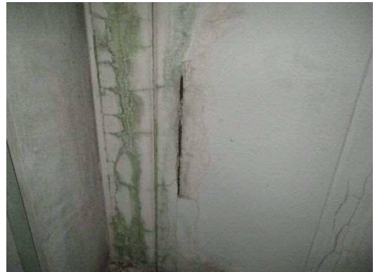
【鉄筋の露出とコンクリートの剥落】
