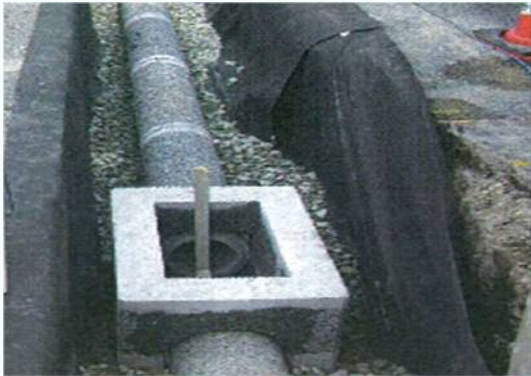
雨水浸透柵・浸透管
