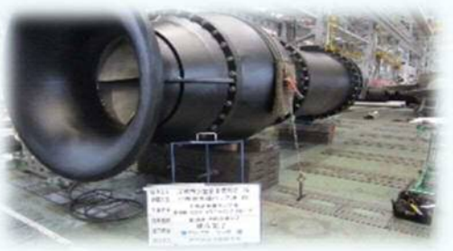
【雨水ポンプ設備の整備後】
