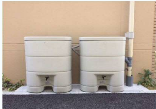
雨水貯留タンク
