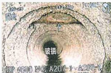
破損した管きよ
