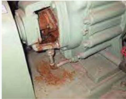
劣化した設備 (東部雨水ポンプ場 真空ポンプシール部腐食)
