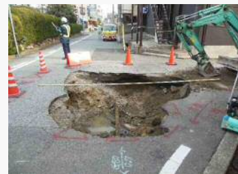
下水管きよが原因の道路陥没
