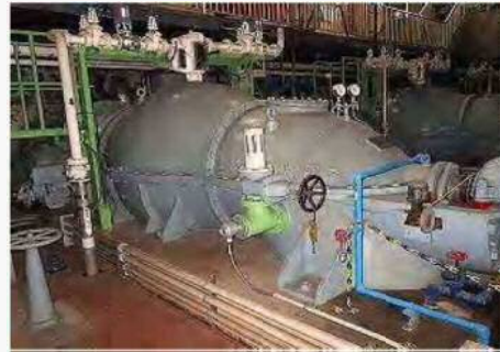
腐食したポンプ設備 (東部雨水ポンプ場 No.3雨水ポンプ)
