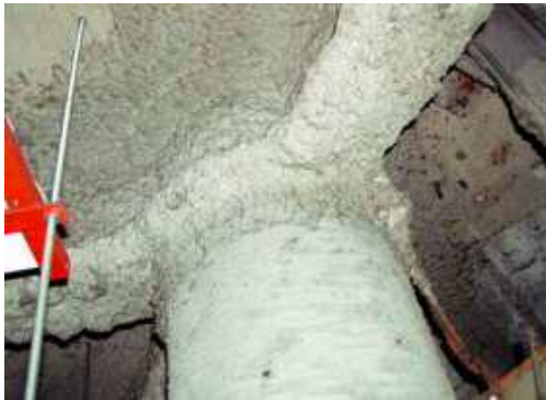
吹付け石綿（レベル1建材）
