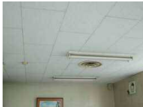
岩綿吸音板（レベル3建材）
