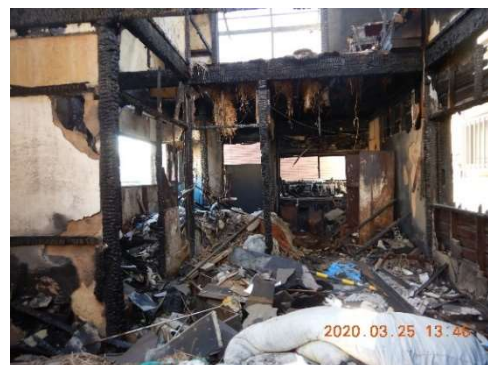
内部の被災状況
