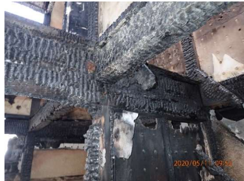
構造材の火災被害
