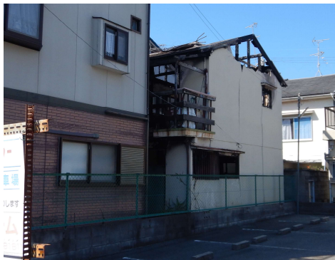
建物全体（屋根の崩落、外壁ひび割れ）
