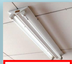
照明器具（蛍光灯）
