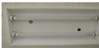
① 蛍光灯を外します
