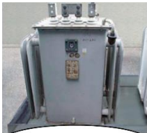
トランス（変圧器）
