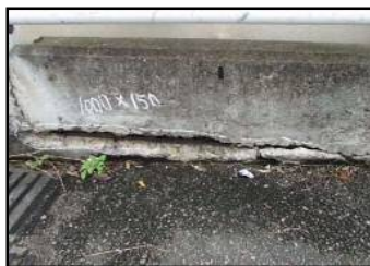
鉄筋露出 (判定区分Ⅲ)
