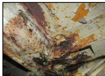
腐食 (判定区分Ⅲ)
