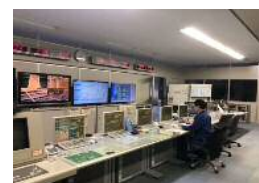
北部浄化センター操作室
