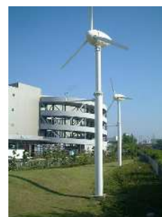
風力発電設備
