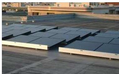
太陽光発電設備
