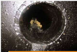
清掃していない排気ダクト内
