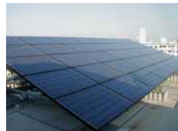
太陽光パネル（杭瀬小学校）
