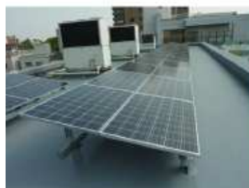
太陽光パネル
