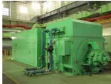
蒸気タービン発電機
