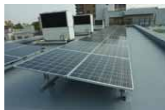
太陽光パネル
