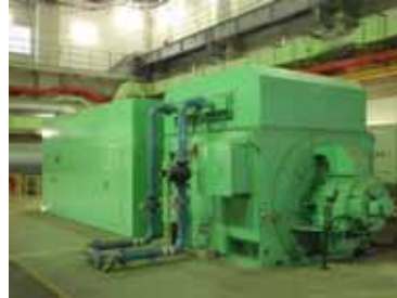
蒸気タービン発電機
