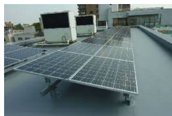
太陽光パネル
