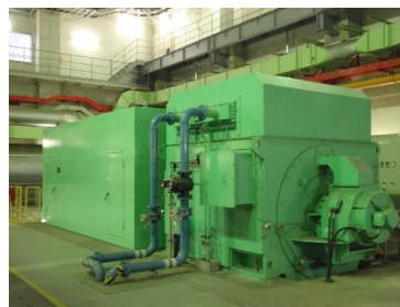
蒸気タービン発電機
