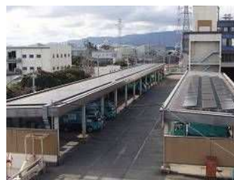
太陽光パネル
