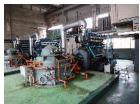
中在家中継ポンプ場 改築予定雨水ポンプ 供用開始：昭和41年
