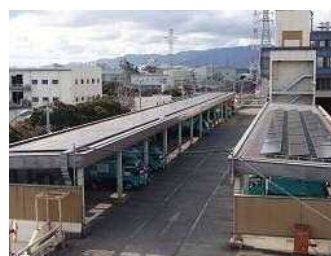
太陽光パネル
