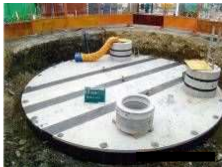
公園に備えた耐震性防火水槽
