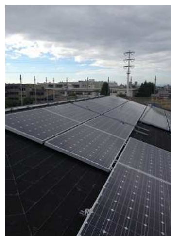
制度活用事例 不二電気工事株式会社 自社事務所
