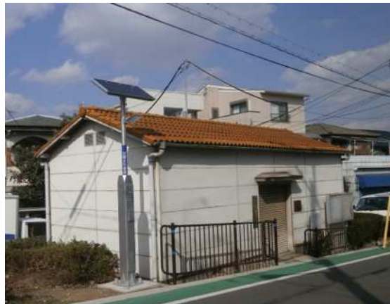
水防倉庫に設置された太陽光・蓄電池併設型 LED 灯
