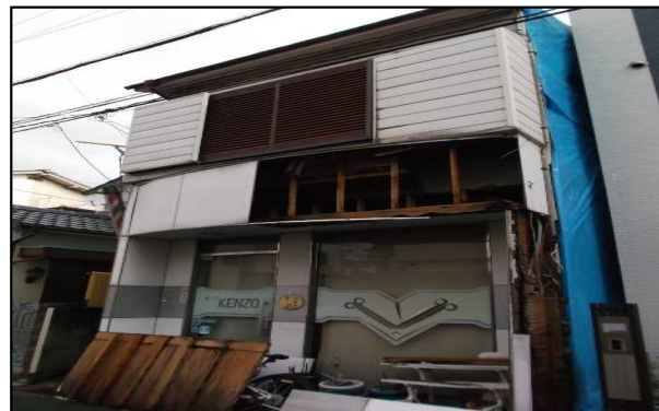
建物正面及び南側壁面ブルーシート
