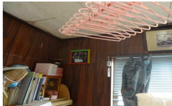
2階雨水流入による腐食等
