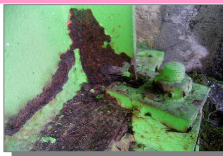
橋桁が腐食し穴が空いています
