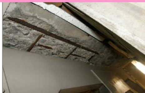
コンクリートが剥離し鉄筋が腐食しています 立花陸橋(46歳)健全度5.7点 平成26年度に対策を終えています。
