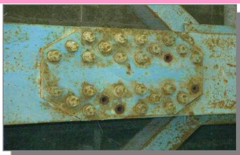
橋桁のボルトが脱落しています
