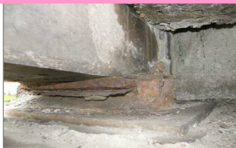
支承の腐食が進んでいます 港橋(61歳)健全度5.7点 平成26年度に対策を終えています。
