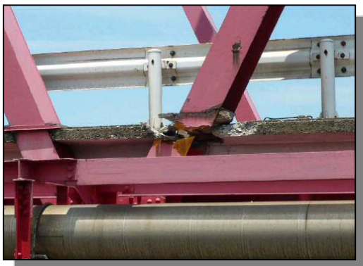
三重県 国道23号 木曾川大橋（トラス橋）の鋼材の破断 出典：国土交通省
