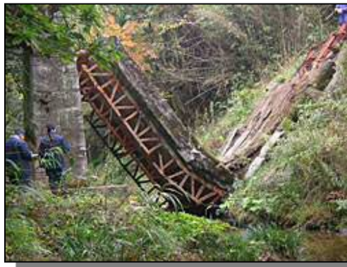
香川・徳島県境（2007年） 無名橋（トラス橋）の落橋 出典：構造物メンテナンス研究センター （CAESAR・シーザー）
