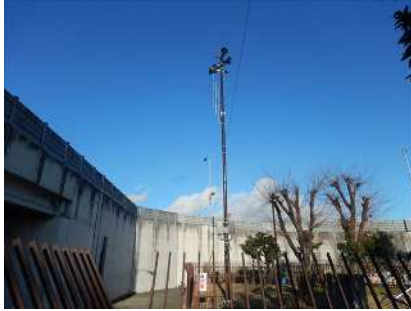
西川中継ポンプ場に設置した屋外拡声器
