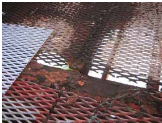
エキスパンドメタル腐食状況
