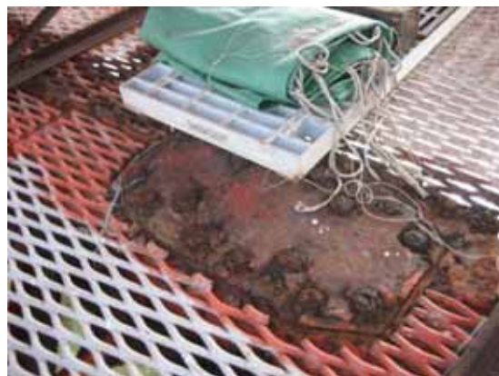
上部工腐食状況
