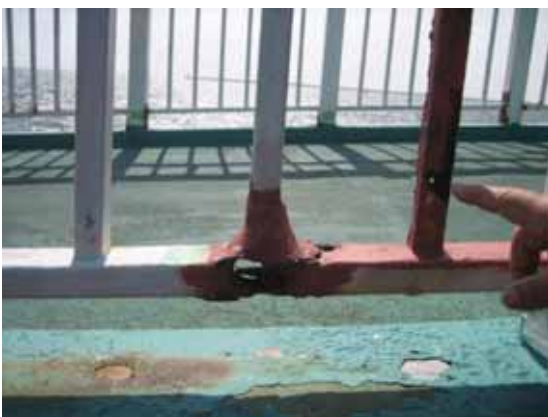
手すり腐食状況
