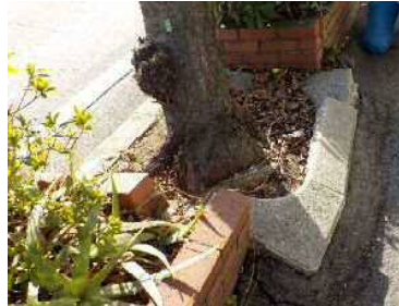
街路樹の根上がり
