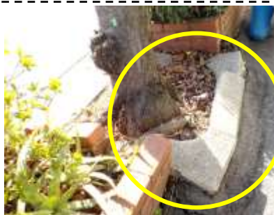
街路樹の根上がり
