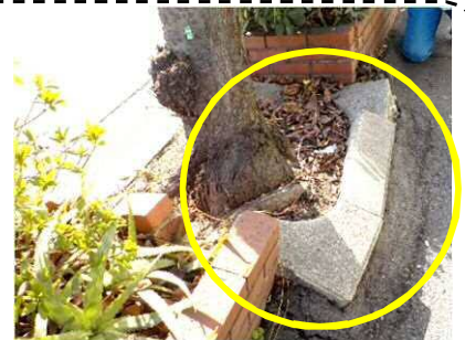
街路樹の根上がり
