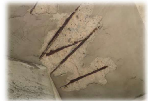
鉄筋がむき出しに (千代木園)
