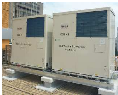
コージェネレーションシステム
