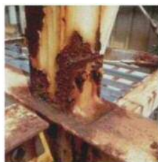
鉄骨のボルトのサビによる腐食
