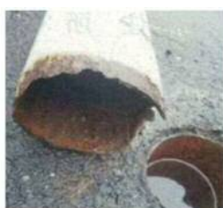
ポール看板の根腐れによる倒壊
