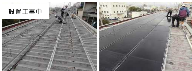
設置後（第1工場）
