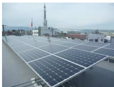
太陽光パネル
